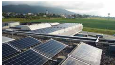
Die neue 300-Kilowatt Photovoltaik-Anlage der Wedl-Zentrale in Mils in Tirol.
